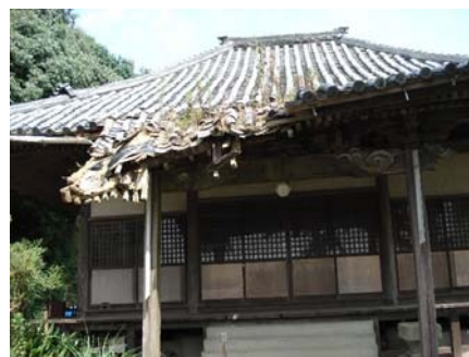
崩れかかった瓦屋根
