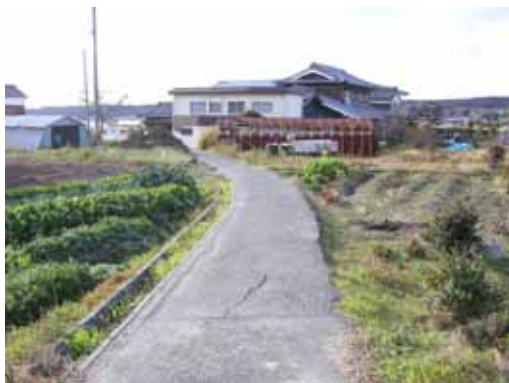
整備が望まれる道路
