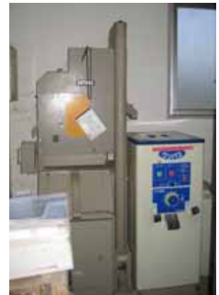
農業倉庫内の精米機
