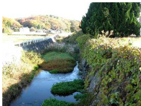
浚渫工事を希望する性海寺川
