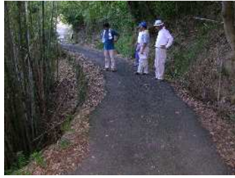
路肩部分が崩れるので はと指摘のあった箇所。
