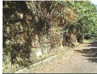
落石防護ネットが古いと指摘あり。確かに錆びている。
