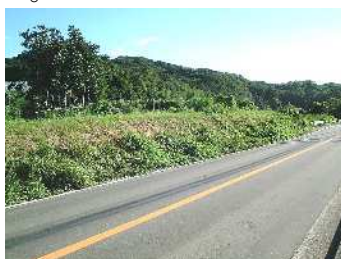
歩道がなく、路側帯も狭 い。大変危険。
