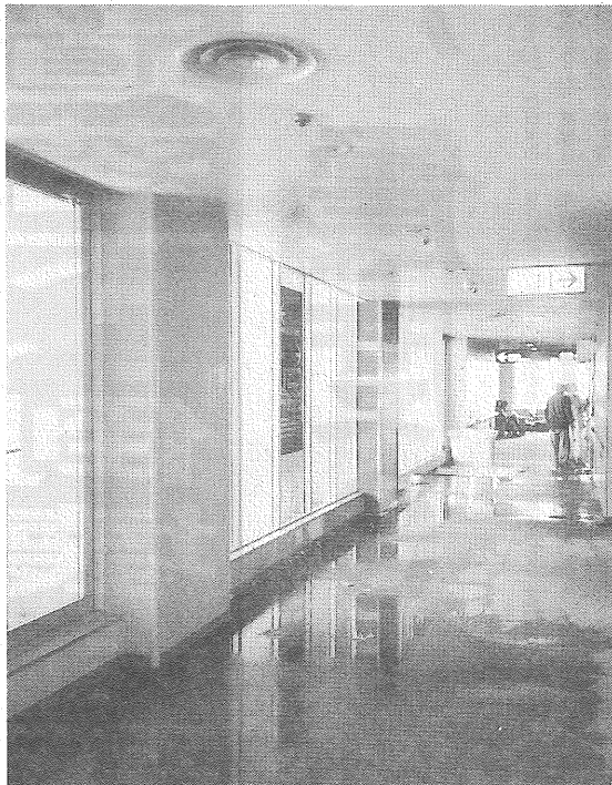
スプリンクラー設備配管の損傷により 病棟の内部は水浸しとなった（高層階）
