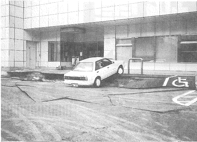
建物の基礎以外の地盤沈下により、駐車場の部分が沈下し、表面に亀裂が入っている
