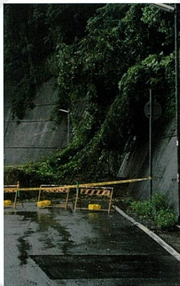
塩屋多井畑線の土砂崩れ
