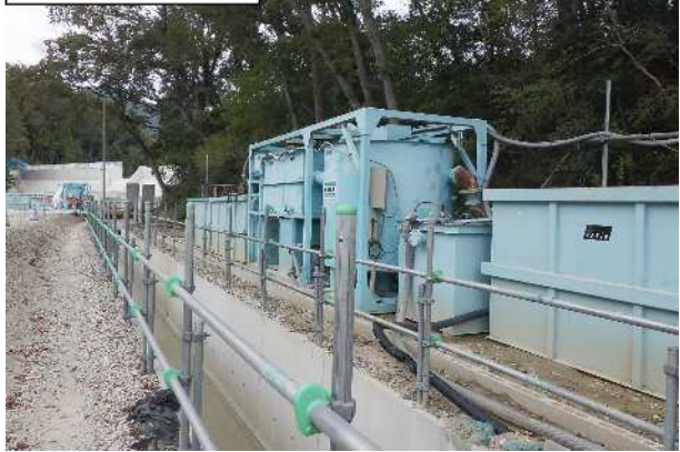
濾過機の設置状況
