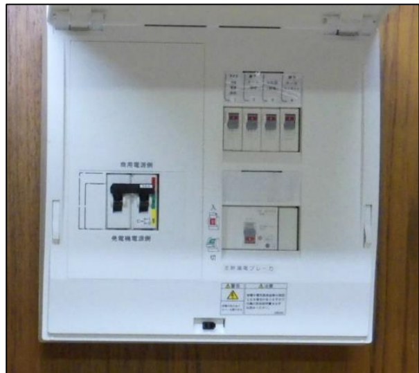
写真2 手動切替器（新設分電盤）
