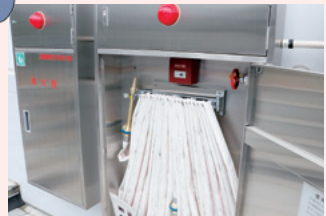
1号消火栓 (2人で操作する)
