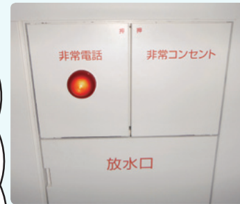
非常コンセント 及び 非常電話
