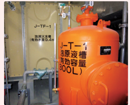
泡原液槽・泡消火水槽
