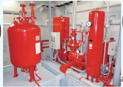
泡消火設備 ポンプ等
