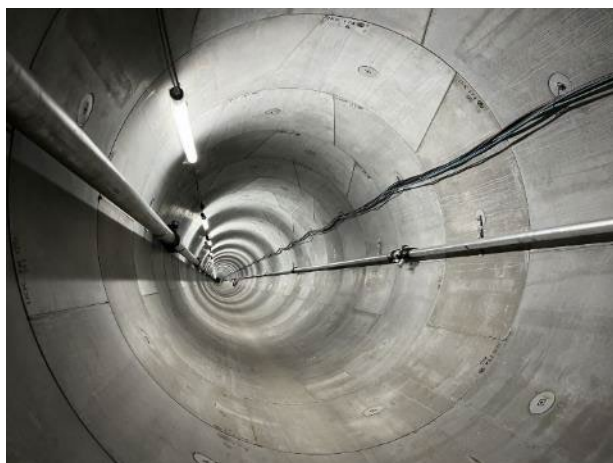
図4 雨水幹線（直径2.2m）
