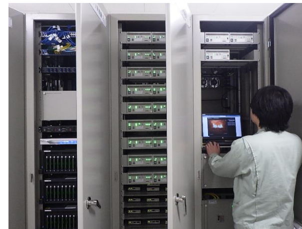
ITV制御装置の点検
