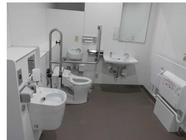
給排水設備（水廻り）
