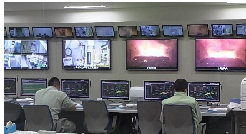
クリーンセンター内中央監視室
