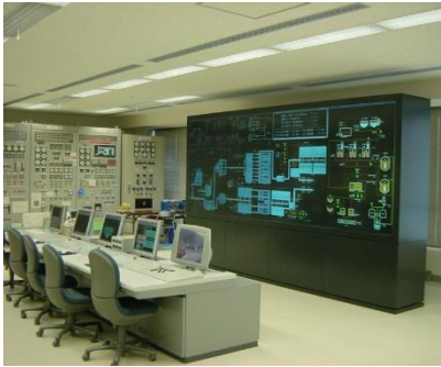
中央監視設備
