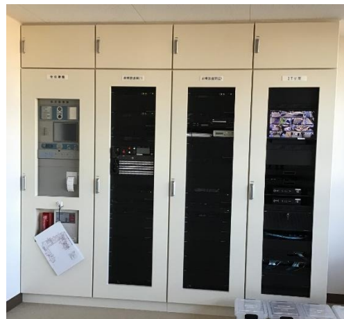
自動火災報知設備、放送設備
