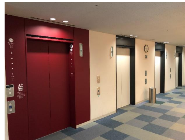
エレベータ（昇降機設備）
