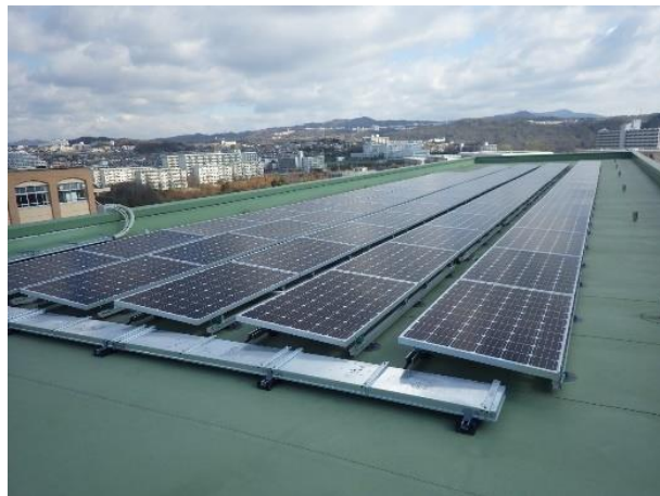
太陽光発電設備
