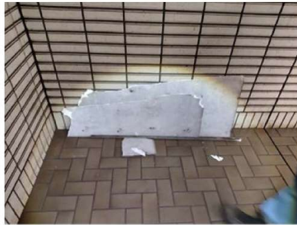
令和4年3月 ホーム天井 側壁のボードおよび金属材落下 ボード：122cm×78cm×厚さ8mm 重さ5.2kg
