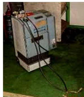
■フロン類回収設備
