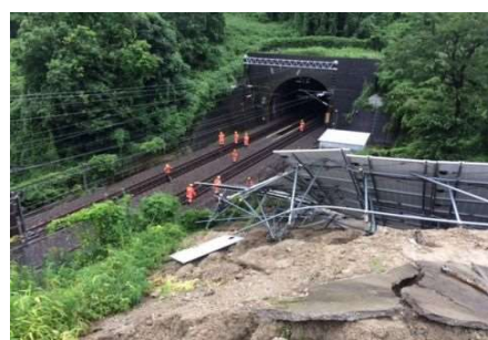
<神戸市内の事例>(2018年7月豪雨による崩落)
