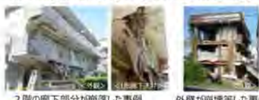
2階の廊下部分が崩落した事例
