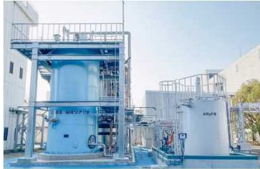
リン回収設備（西区 玉津処理場）
